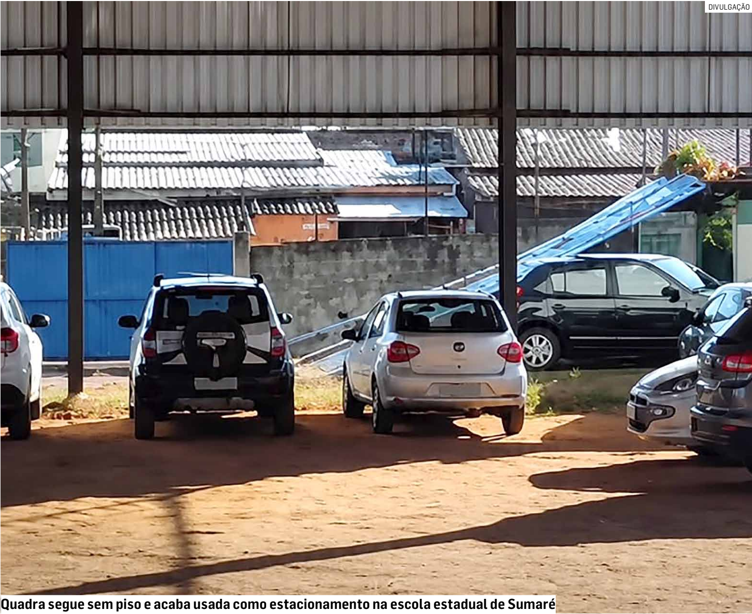
Quadra segue sem piso e acaba usada como estacionamento na escola estadual de Sumaré
