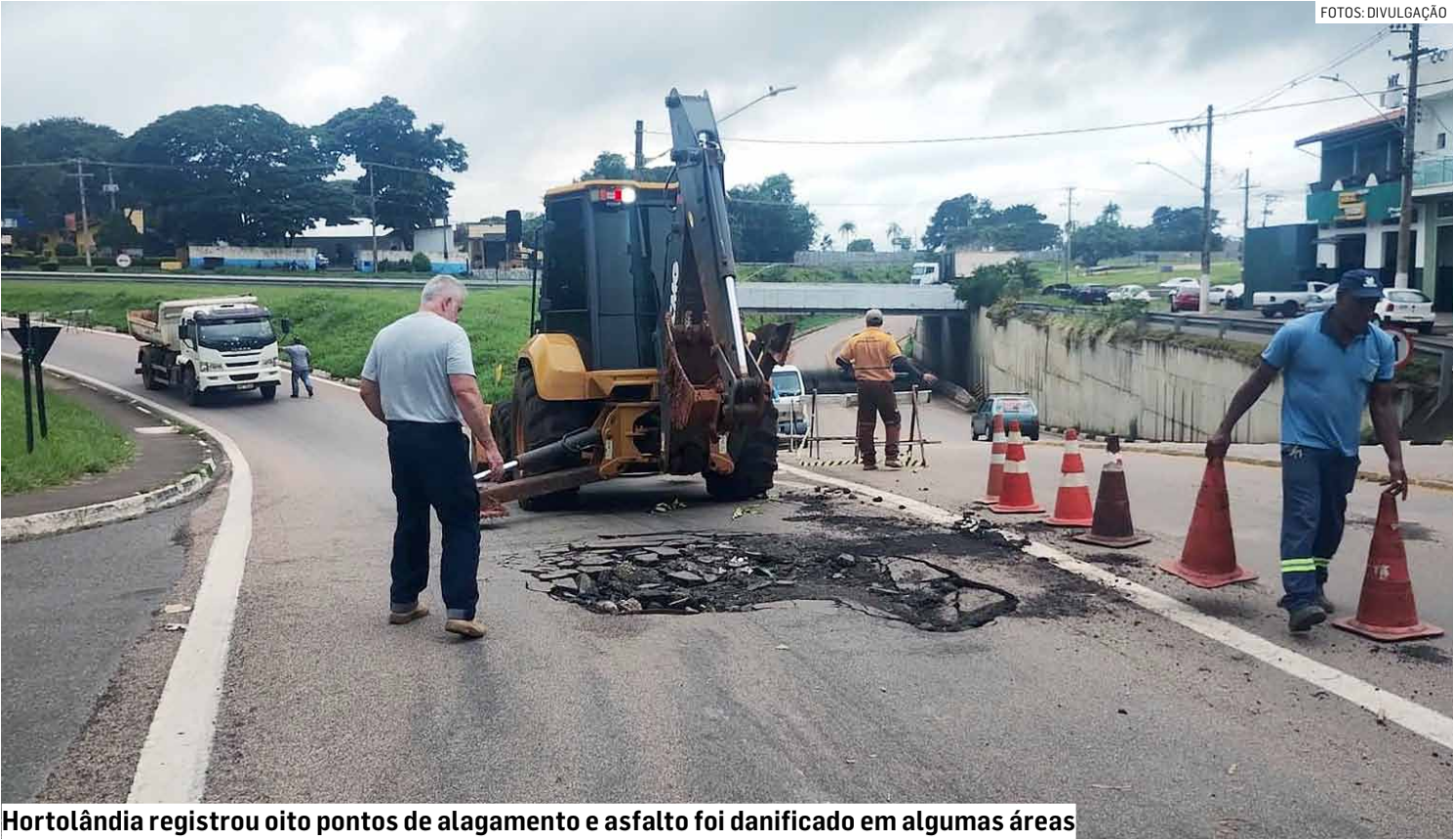
Hortolândia registrou oito pontos de alagamento e asfalto foi danificado em algumas áreas
