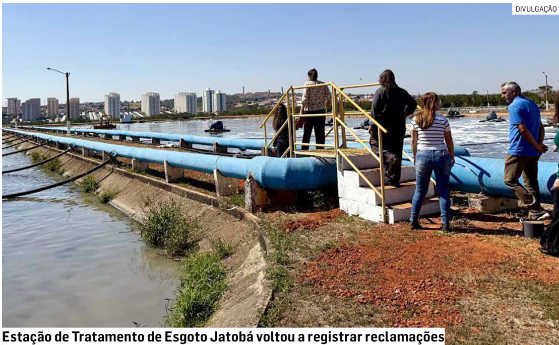
Estação de Tratamento de Esgoto Jatobá voltou a registrar reclamações
