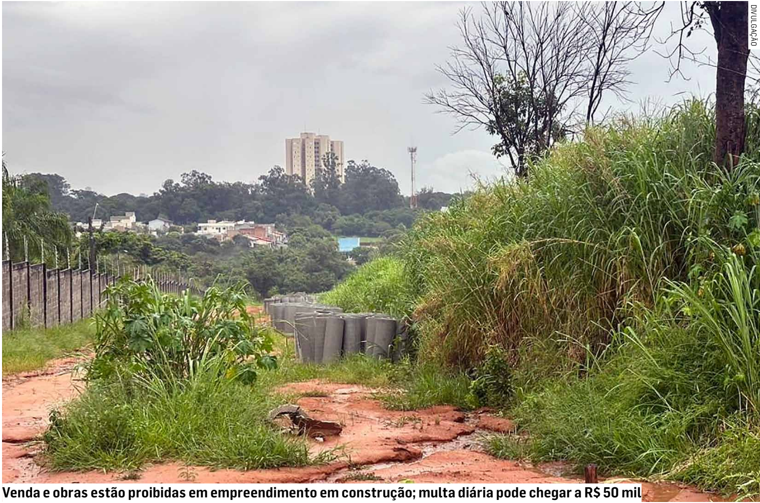
Venda e obras estão proibidas em empreendimento em construção; multa diária pode chegar a R$ 50 mil
