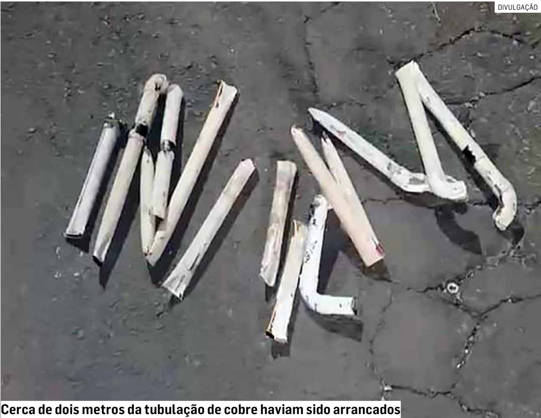
Cerca de dois metros da tubulação de cobre haviam sido arrancados
