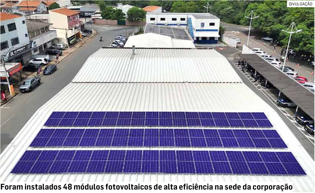
Foram instalados 48 módulos fotovoltaicos de alta eficiência na sede da corporação
