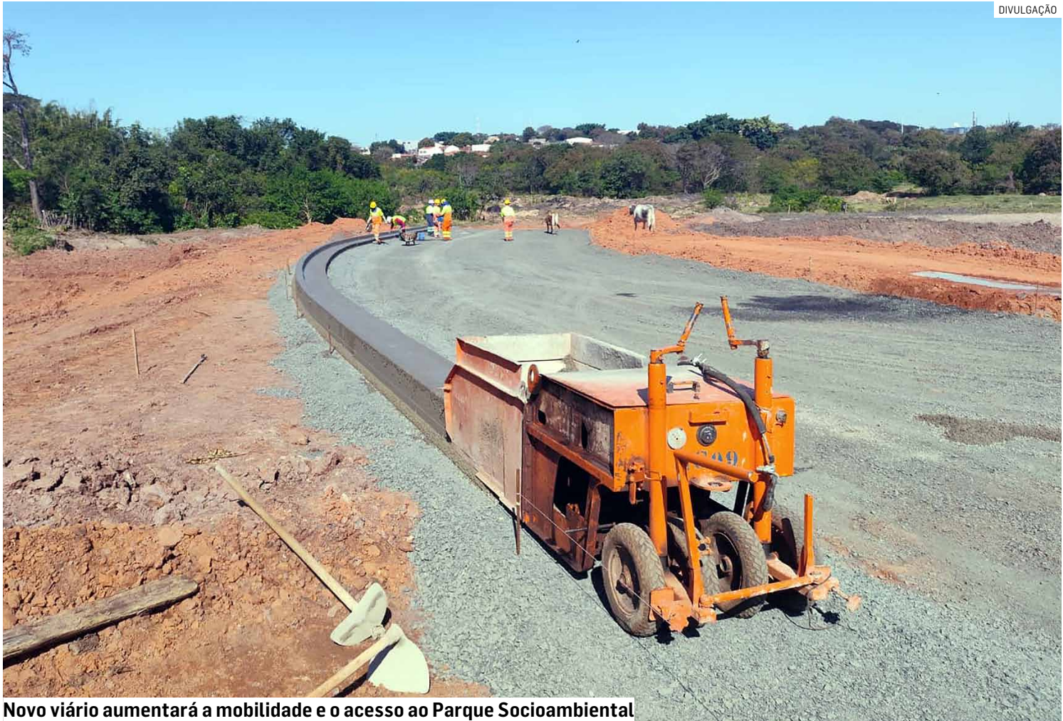
Novo viário aumentará a mobilidade e o acesso ao Parque Socioambiental
