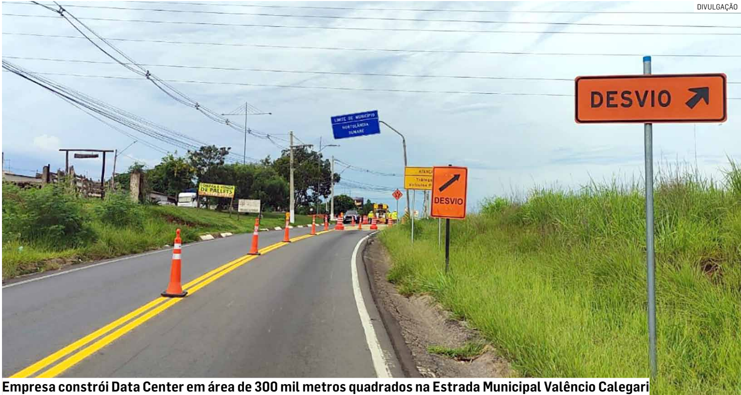
Empresa constrói Data Center em área de 300 mil metros quadrados na Estrada Municipal Valêncio Calegari
