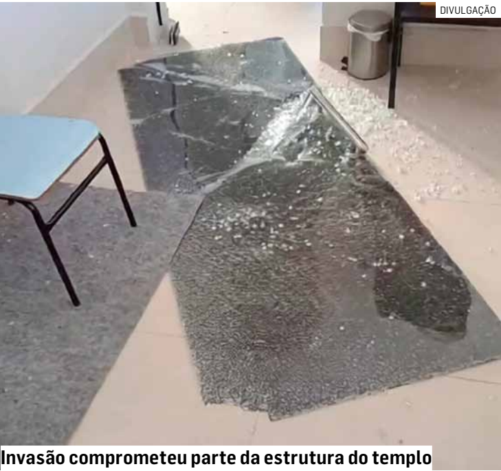
Invasão comprometeu parte da estrutura do templo
