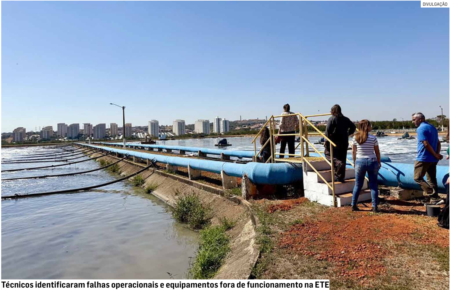
Técnicos identificaram falhas operacionais e equipamentos fora de funcionamento na ETE
