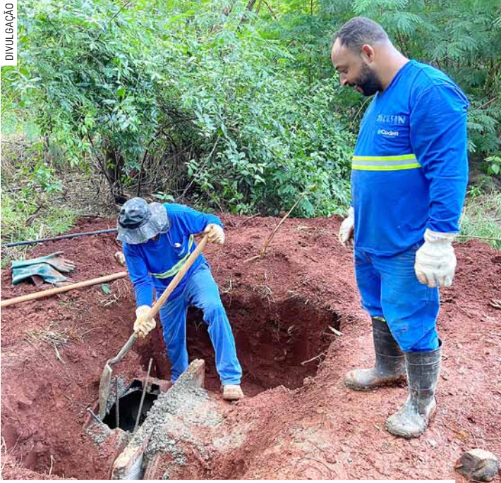
Coden inutilizou temporariamente extravasor na ETE
